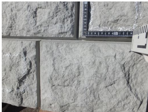
計測範囲が写真フレームから外れている
