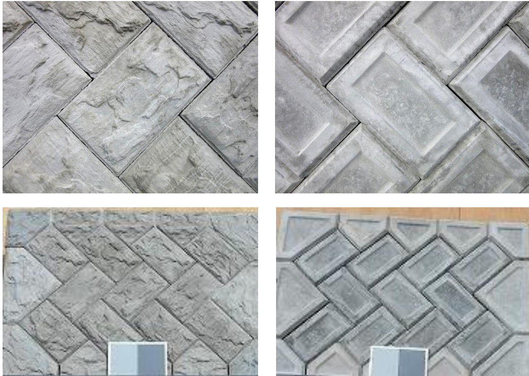
写真-7 汚れ、色ムラの例
